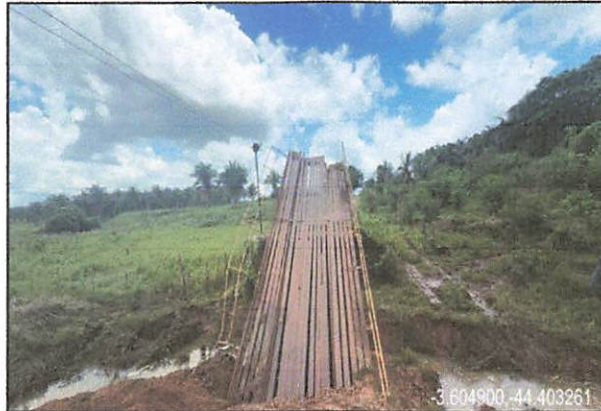
Foto – Obs: Trilhos do passa-rodas intactos, com danos no guarda-corpo lateral
