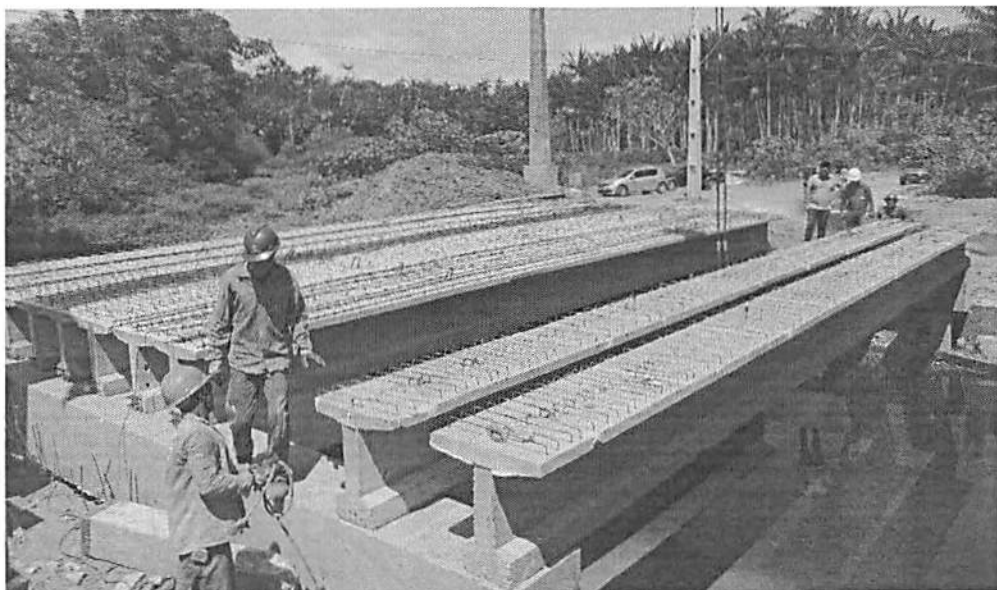
Figura 8: Vigas Protendidas apoiadas na cabeceira da ponte sem a necessidade de escoras.
