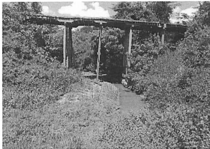
Imagem 01: Foi catalogada no interior do leito do igarapé podendo ser visto que seu leito se encontra quase seco em sua totalidade.
